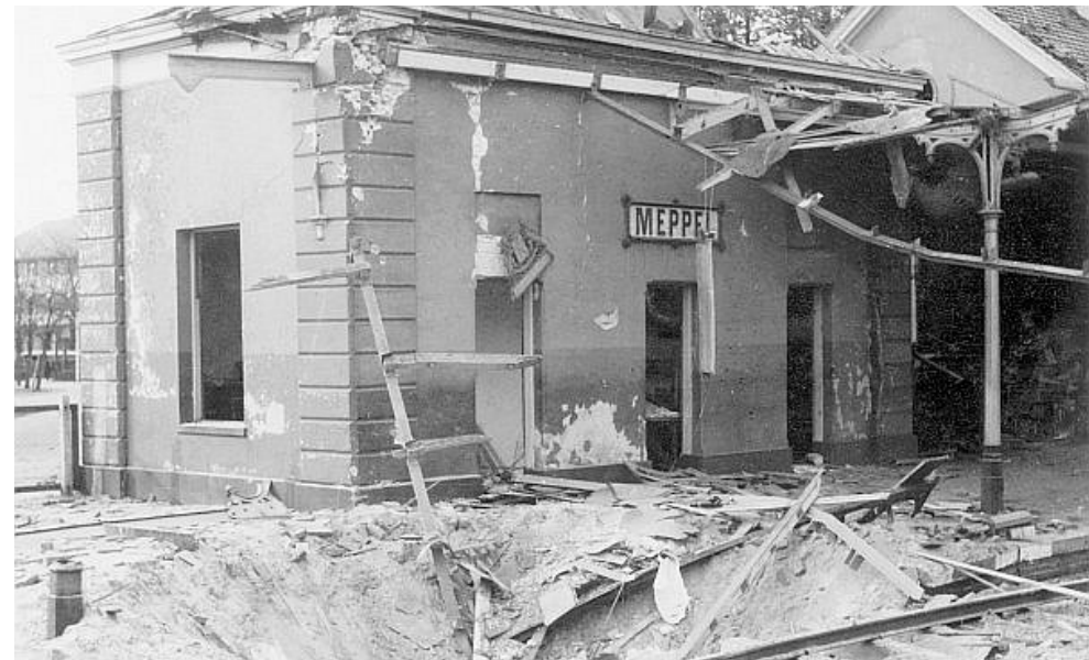
07. Oorlogsschade aan het station, 1945. [Oud-Meppel]
