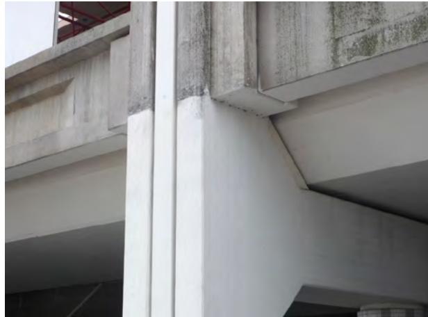
Naar boven doorgestoken pijler met geïntegreerde hemelwaterafvoer.
