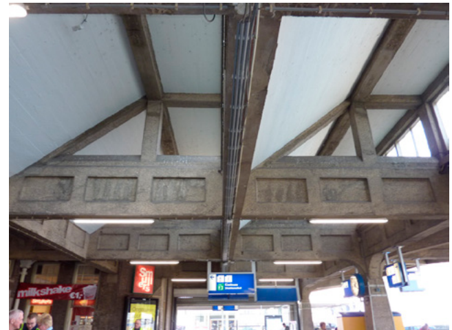
Sheddaken in de perronkap van het kopperron ter hoogte van de doorgang.
