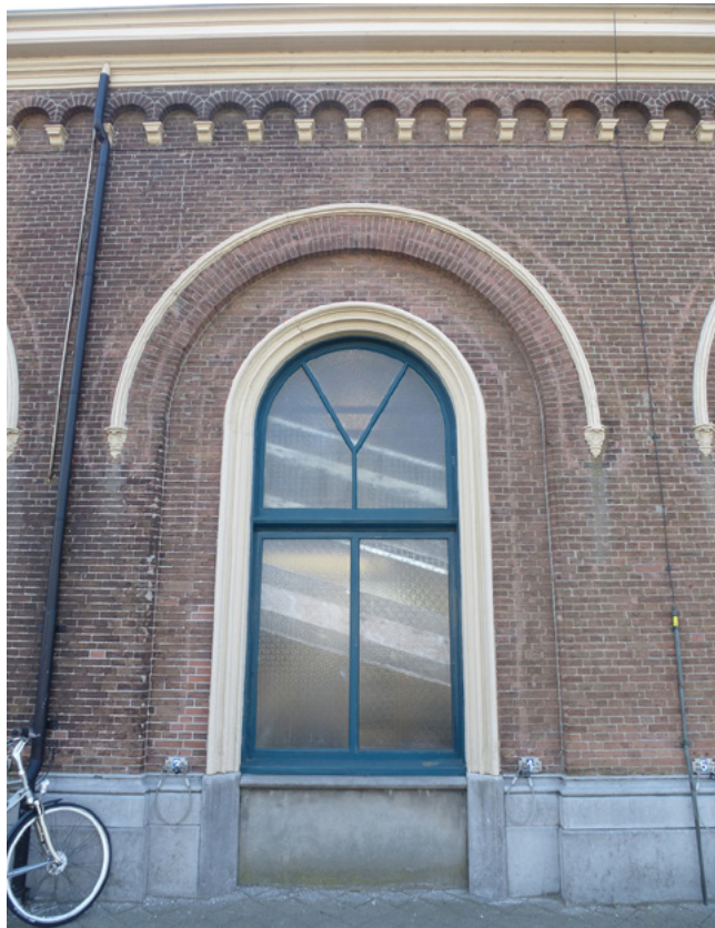
De kozijnen en de roede verdeling van alle vensters en deuren zijn niet meer origineel. Sommige deuropeningen zijn vervangen door een raam (herkenbaar aan het kleurverschil van het natuursteen in de plint).
