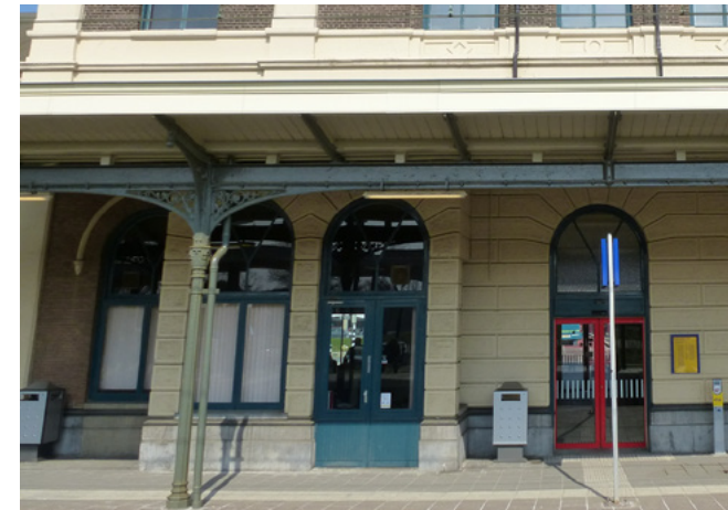
Aanbouw aan achtergevel. Voor het eerst op kaart in 1923, maar waarschijnlijk ouder. Vormgeving passend bij het bestaande.
