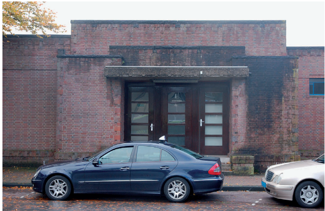
Donkere vlekken als gevolg van lekkage, oorspronkelijke fietsenstalling
