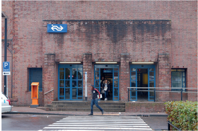
Donkere vlekken als gevolg van lekkage, zuidelijke entree
